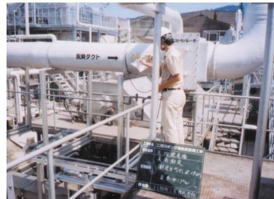
弊社は脱臭装置メーカーの一員として、各地の下水処理場や屎尿処理場の脱臭現場での臭気分析に実績があります。
